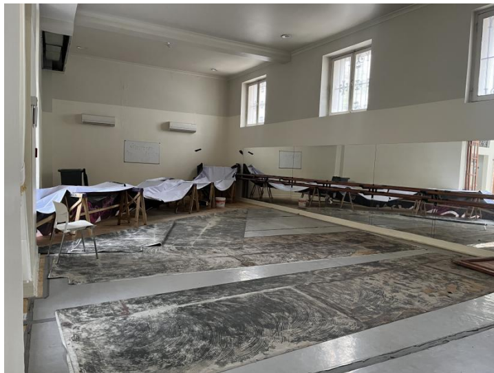
Sala de ensayo de la Escuela de Ballet del Municipal de Santiago durante lluvias del 2023.
