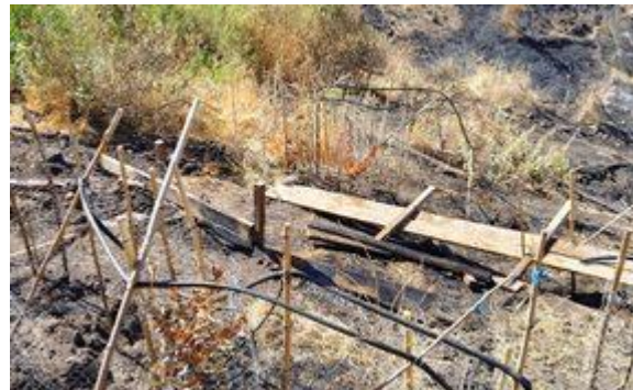
Infraestructura dañada por el fuego
